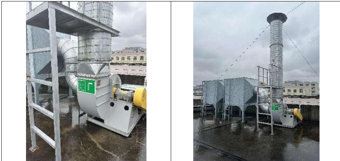
图 4-4 废气设施及标识牌
