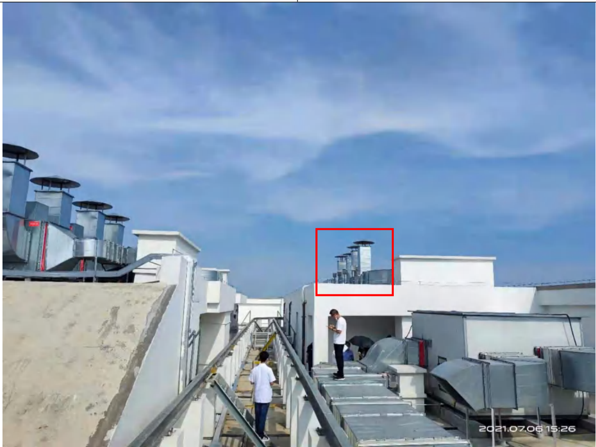
检测中心排气筒
