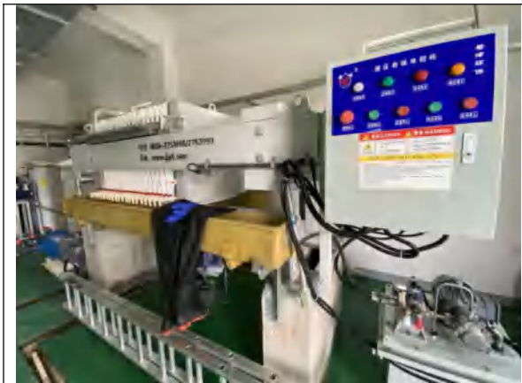
图 4-5 污泥压滤板框
