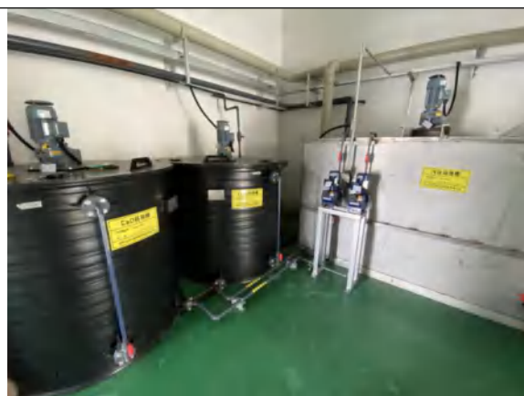
图 4-4 药剂桶及污泥调理槽
