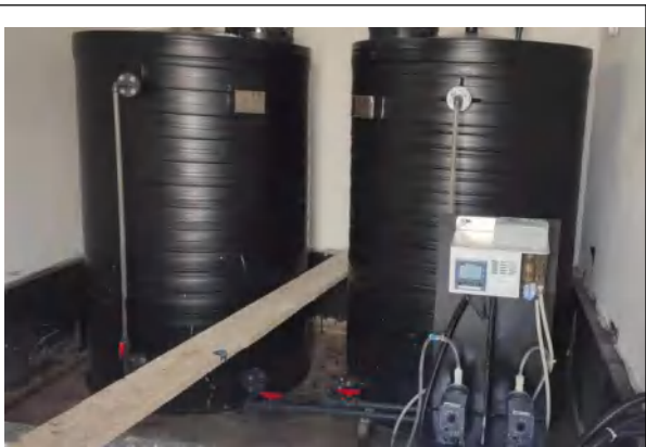
图 4-6 污水站次氯酸钠溶液储桶
