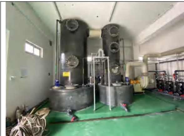
图 4-10 一级洗涤塔+二级生物塔
