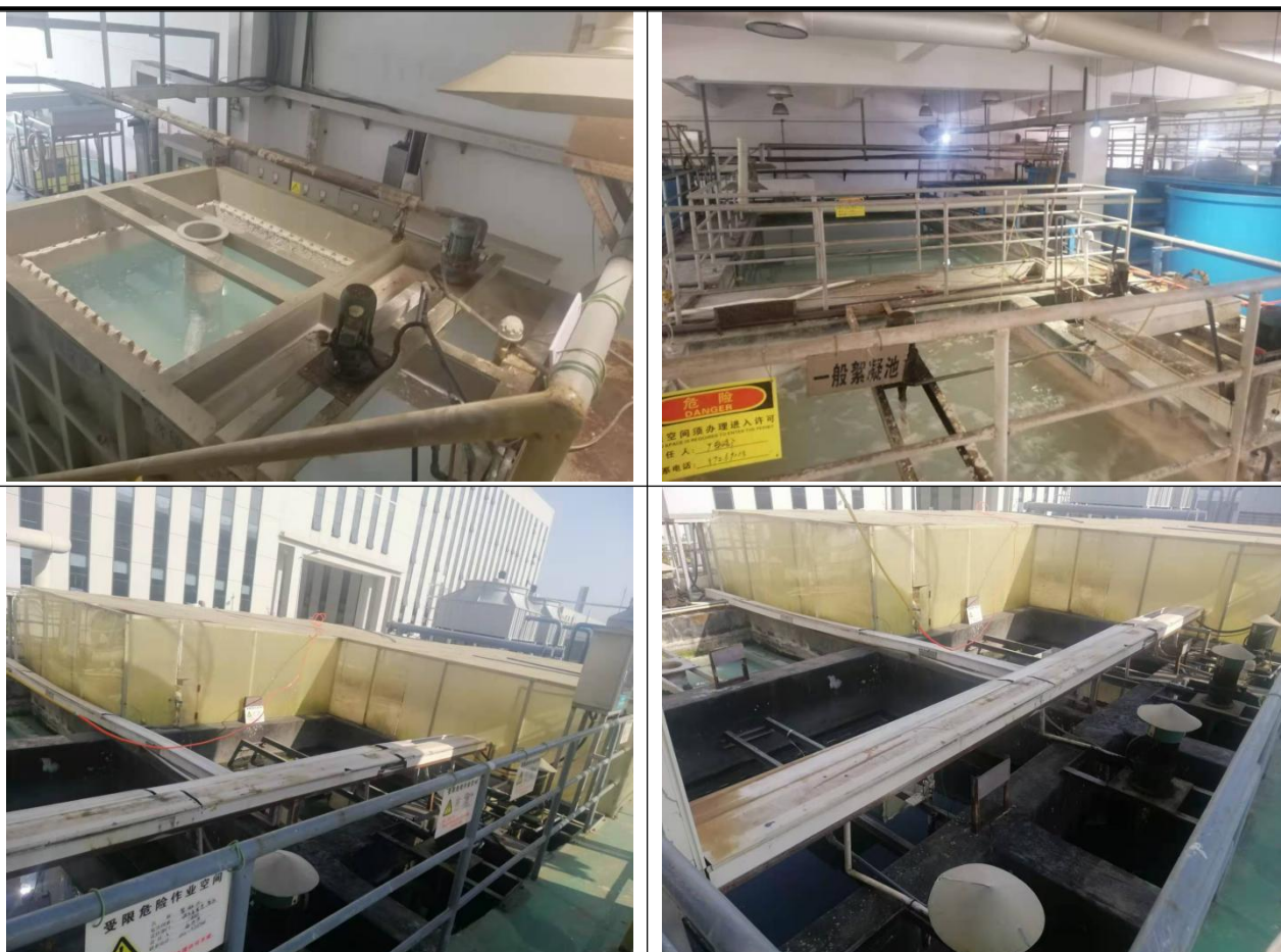
图 4-2 废水处理设施
