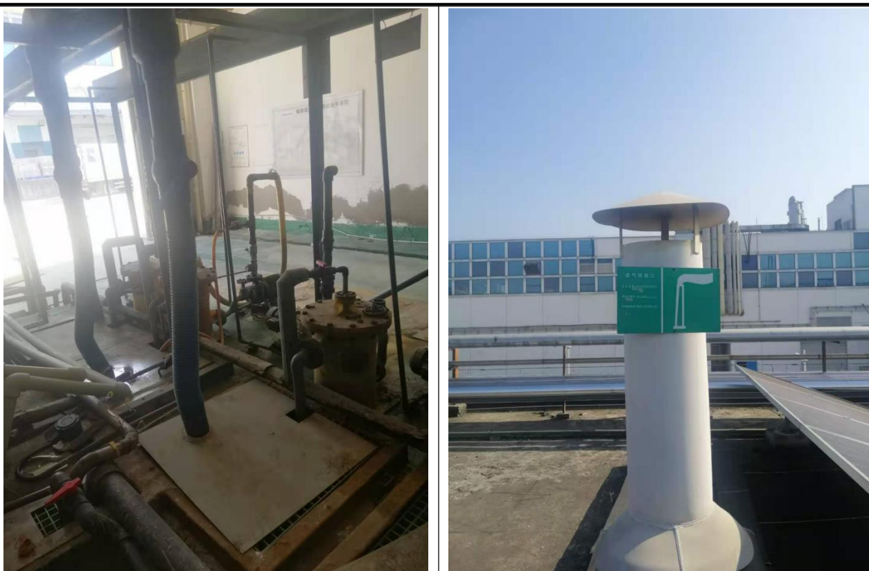
图 4-4 废气收集措施及排气筒照片
