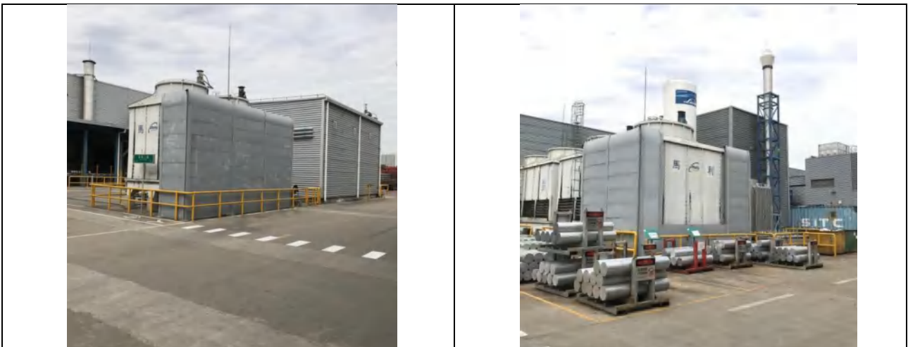
图 4-4 冷却塔降噪设施照片
