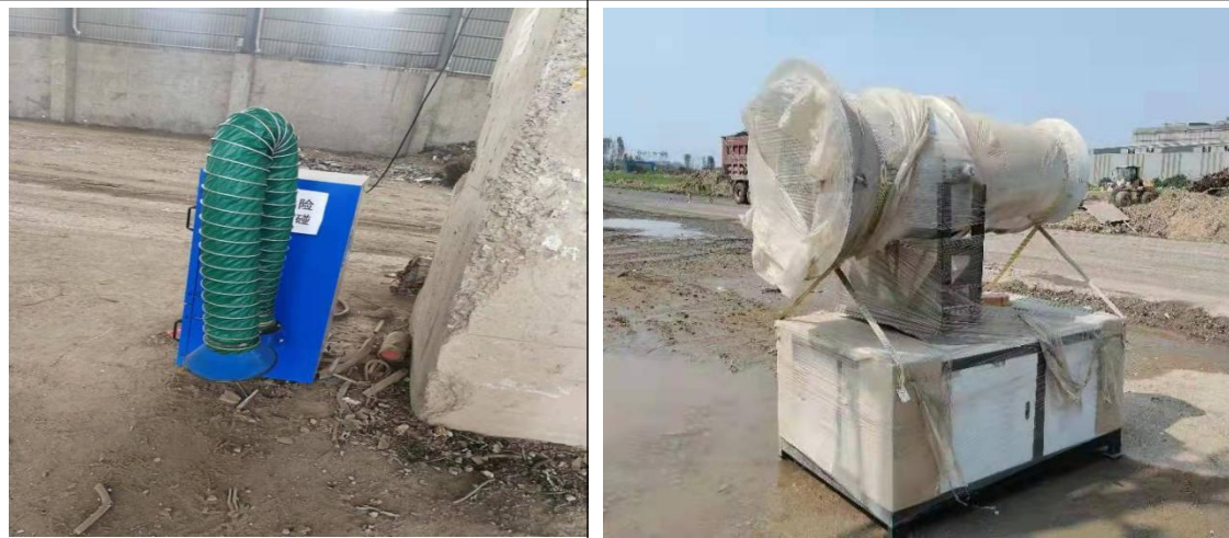
废气处理设施
