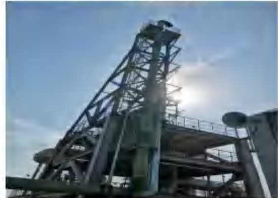
MTD 装置氢化尾气排口
