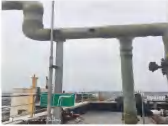
盐酸装置尾气吸收排口
