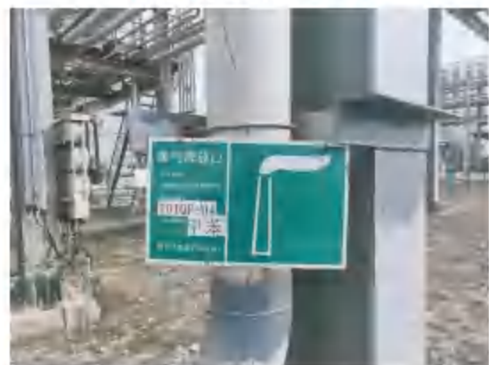
活性炭吸附罐尾气处理系统排口
