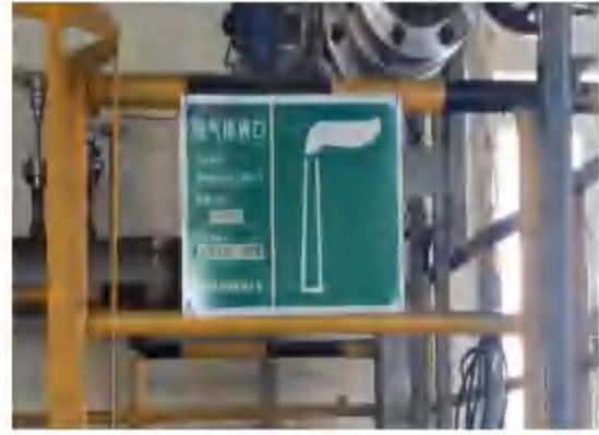
硝酸吸收塔尾气排口
