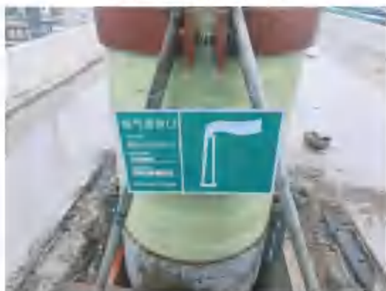
生物滤塔排口
