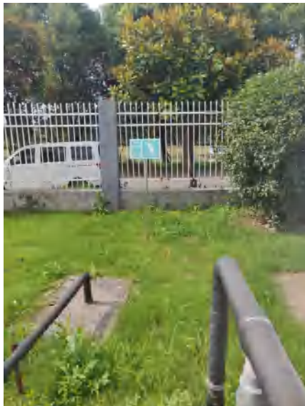
雨水排污口标识牌
