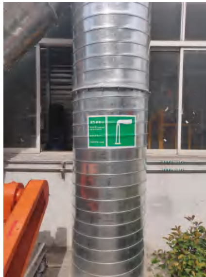
废气排气筒标识牌
