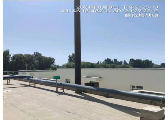
等离子活性炭一体机排口
