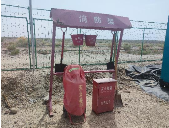
消防设施（钻井期）
