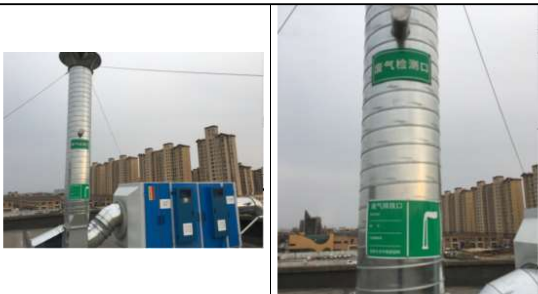
图 4-3 废气排气筒照片
