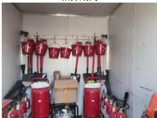
消防设施（钻井期）
