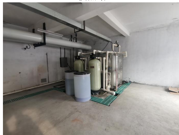
软水制备设施
