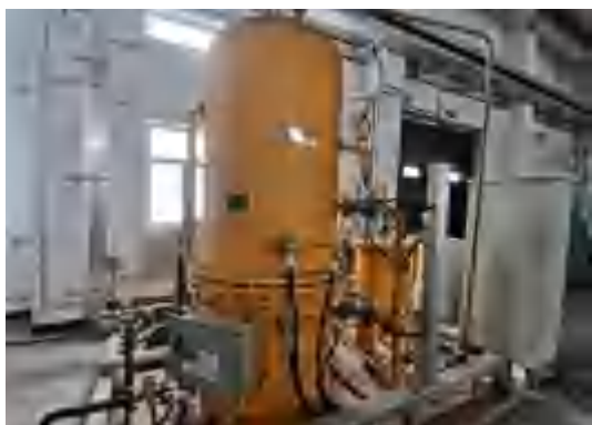
含油废水处理系统
