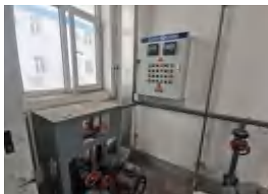
生活污水处理系统控制台
