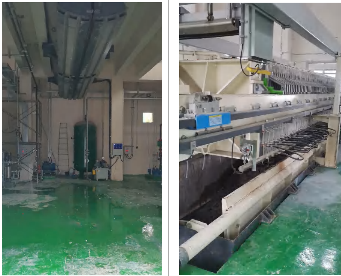
图 7-6 含氟废水处理系统相关照片
