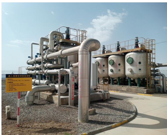
污水治理设施
