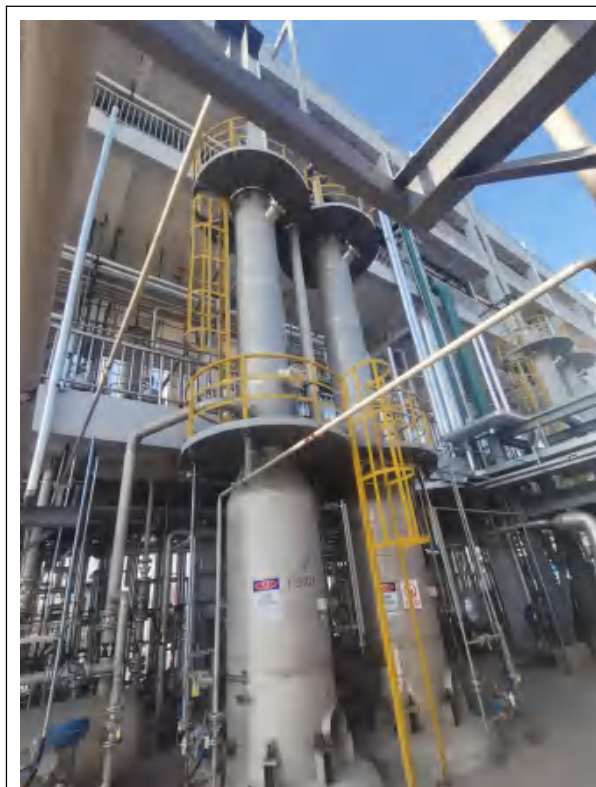
图 4-6 工艺废气处理设施
