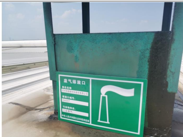
图 4-11 压延车间 7#排气筒
