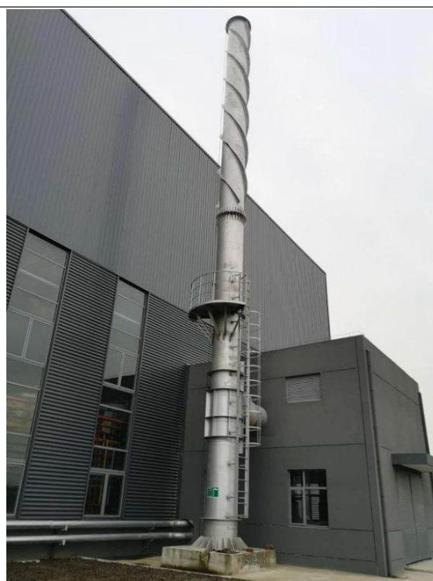
图 4-6 退火炉车间 2#排气筒
