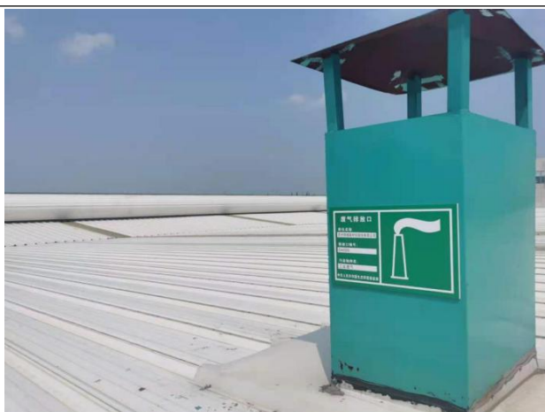
图 4-9 压延车间 5#排气筒
