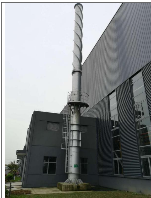
图 4-5 退火炉车间 1#排气筒
