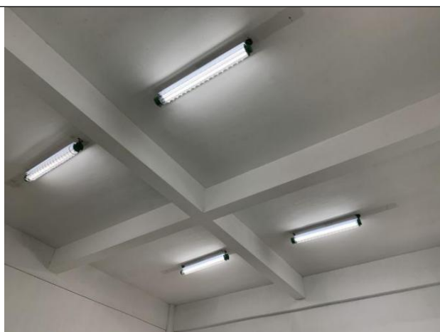
图 4-16 危险固废仓库防爆灯
