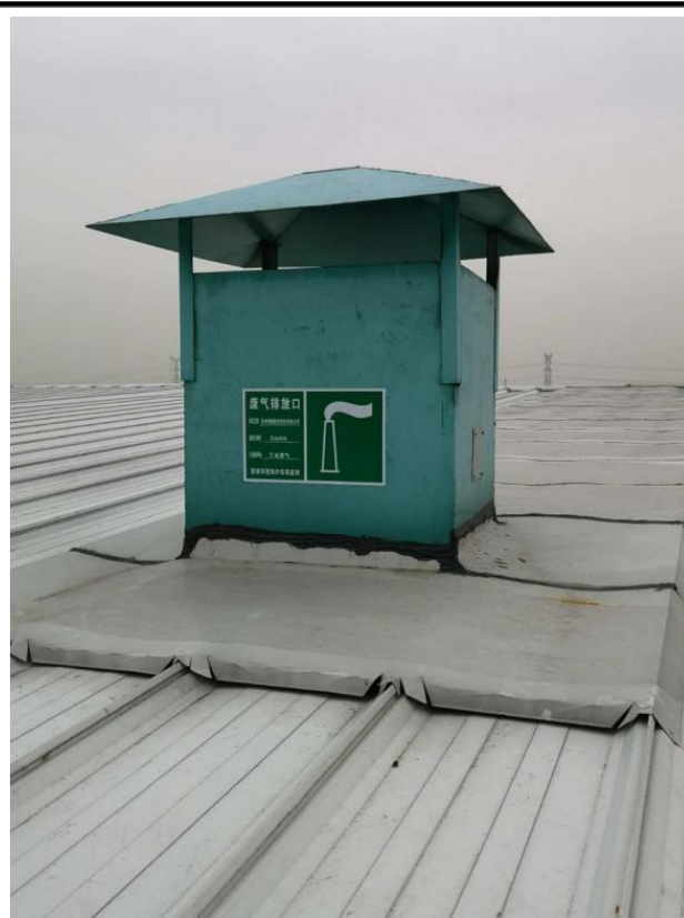
图 4-8 压延车间 4#排气筒
