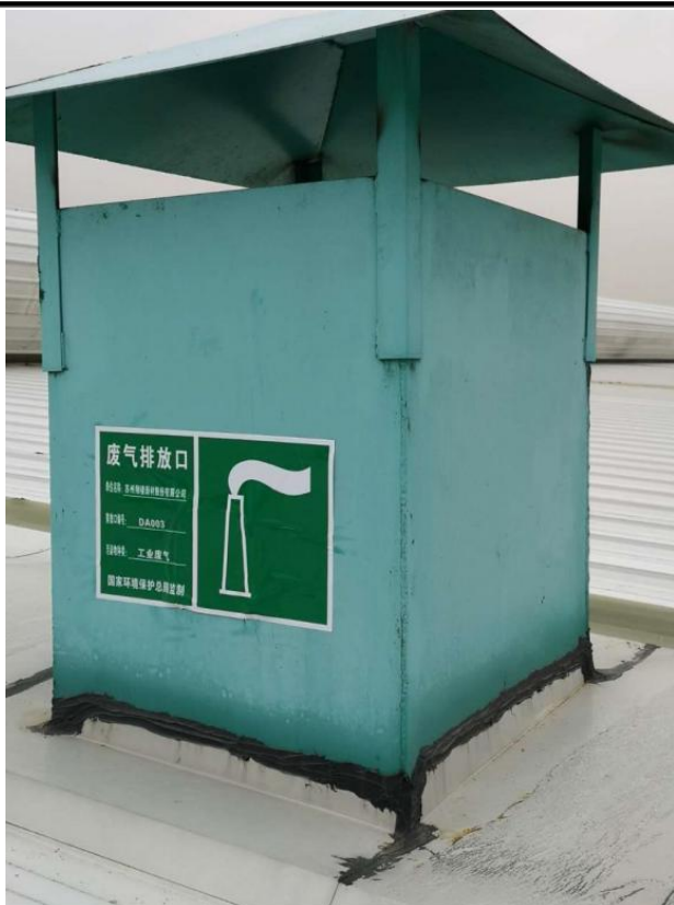
图 4-7 压延车间 3#排气筒
