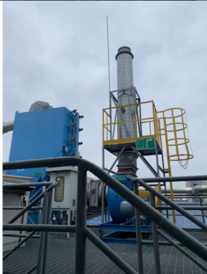
图 4-3 FQ-003、FQ004 废气排气筒及标识牌照片
