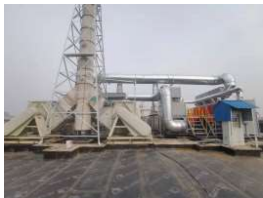
布袋除尘+活性炭吸附脱附+催化燃烧
