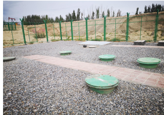
生活污水处理系统
