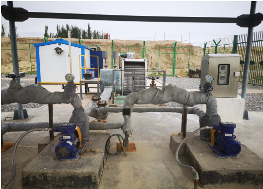
生活污水处理系统
