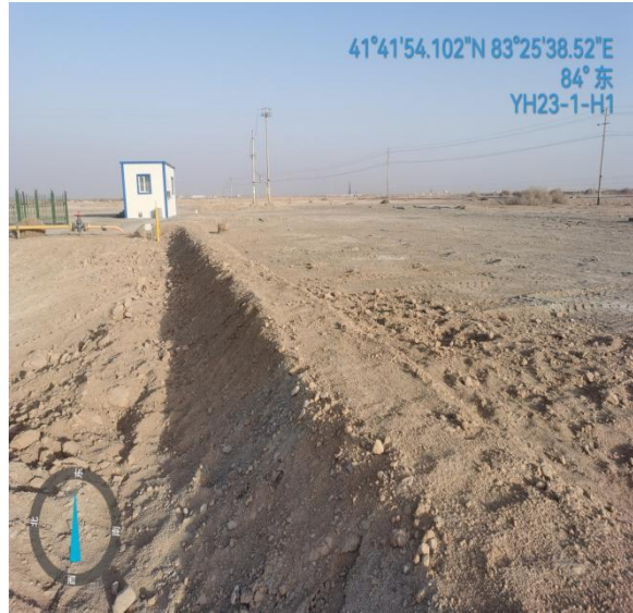
管沟回填隆起
