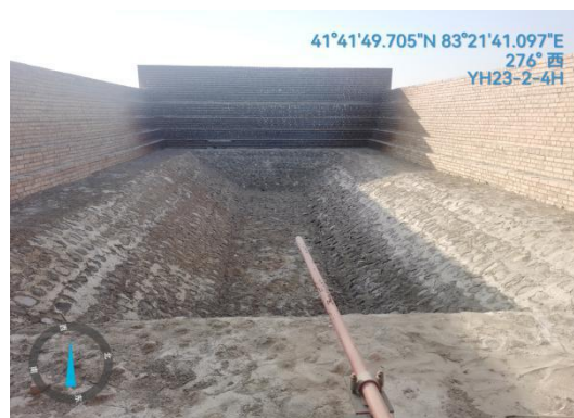
YH23-2-4H 井放喷坑
