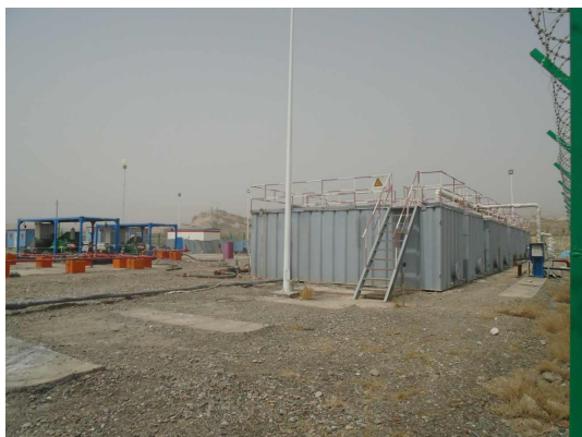
DN210W 井注水罐
