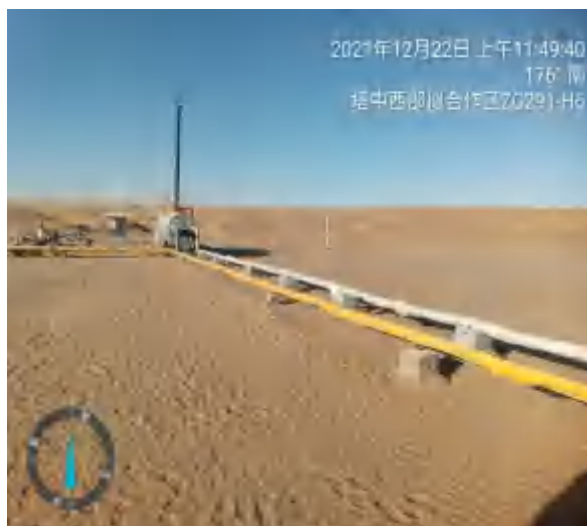
ZG291-H6 井集输管线
