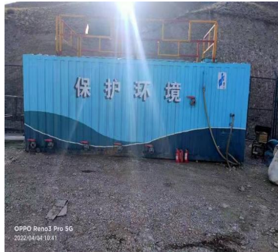
生活污水处理设施
