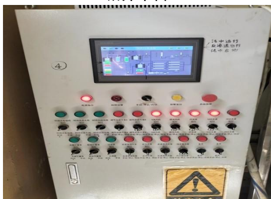
一体化污水处理系统
