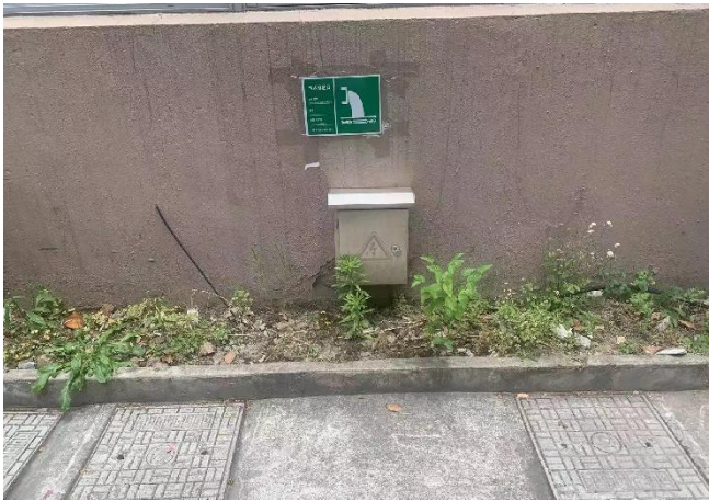
图4-2 污水排放口标识牌
