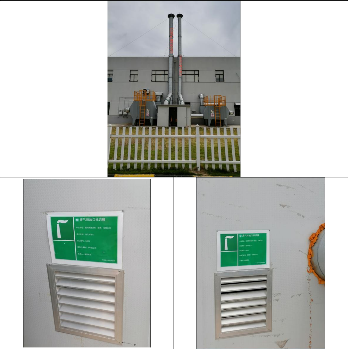
图 4-4 废气排气筒照片及标识牌
