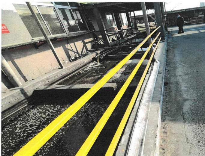
生产废水回用治理设施
