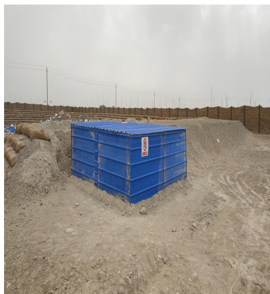
渗滤液收集池
