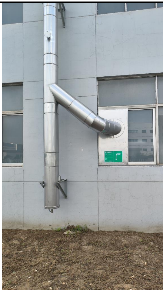
图 4-2 废气排气筒照片及标识牌
