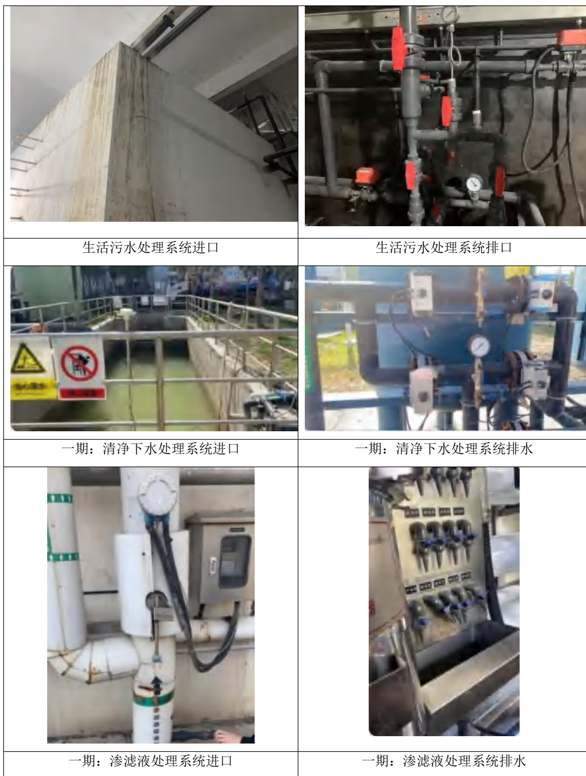
图 4-5 废水处理图现场图
