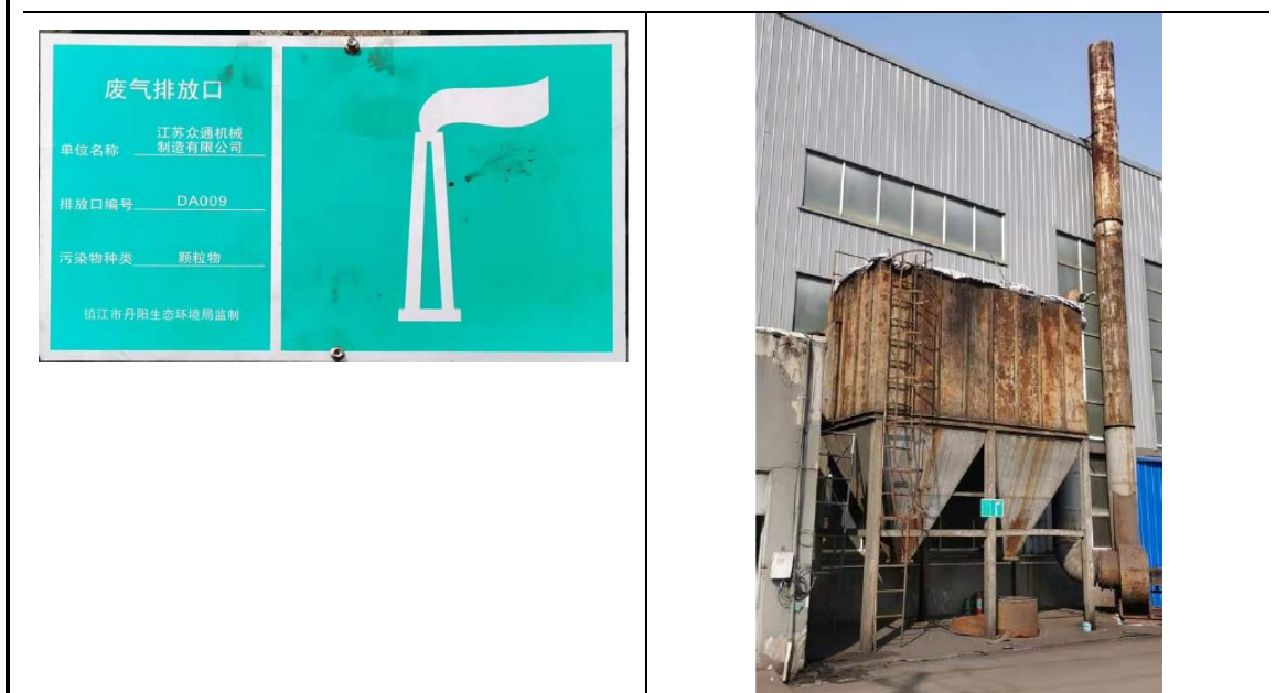
浇注废气排放口
