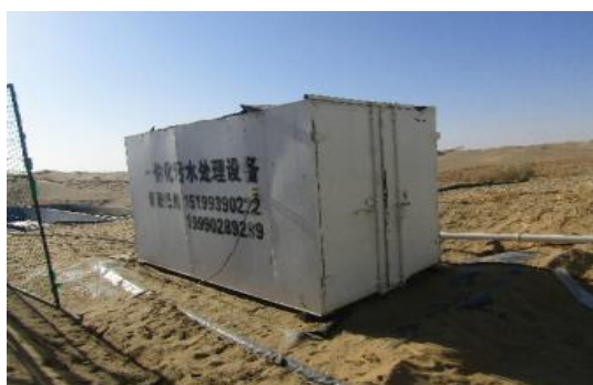
污水处理设施
