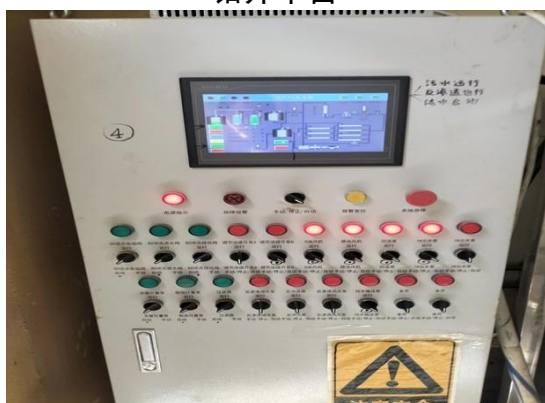
一体化污水处理系统
