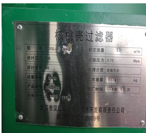
高效节能过滤系统（核桃壳过滤器）
