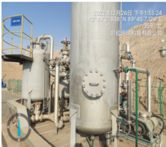
不凝气净化系统
