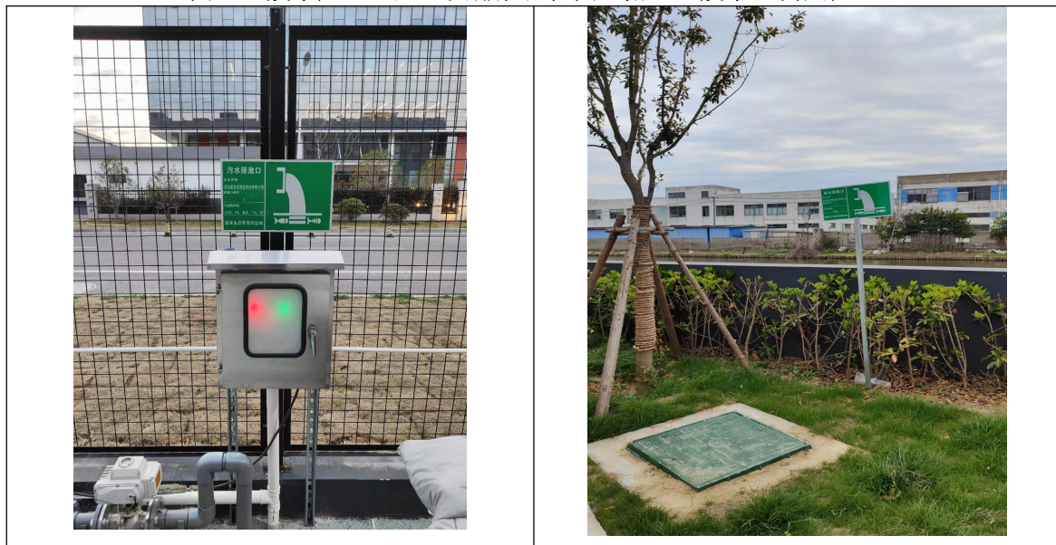
图 4-2 雨水、污水排放口及标识牌图片
