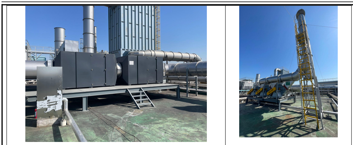
图 4-6 废气处理设施、排放口及标识牌图片
