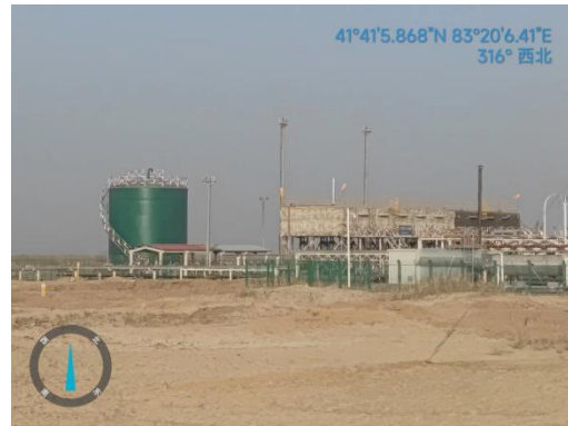
新建外输水罐
