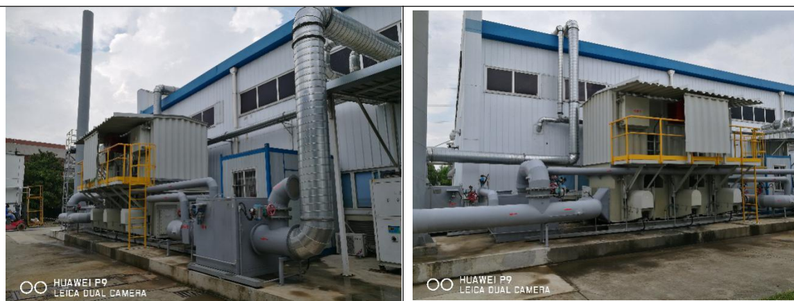
图 4-5 废气处理装置照片
