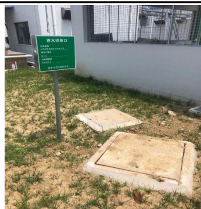
图 4-2 厂区雨水排放口
