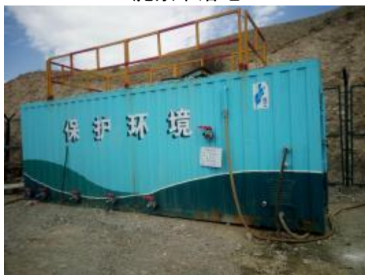
生活污水处理设施
