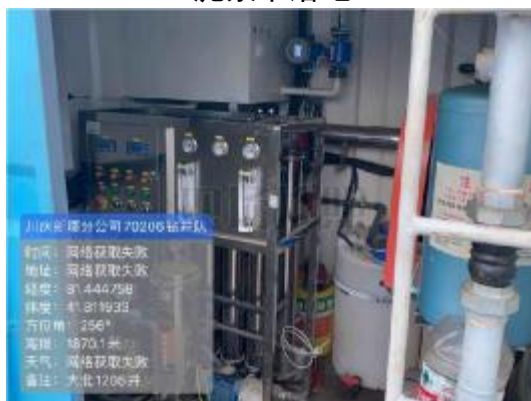
生活污水处理设施
