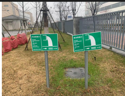
图 4-1 雨水污水排放口及标识牌图片
