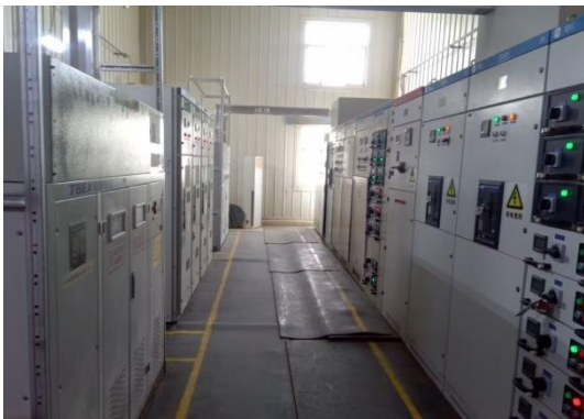
低压配电柜、高压环网柜
