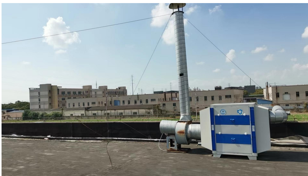
图4-3废气处理设施
