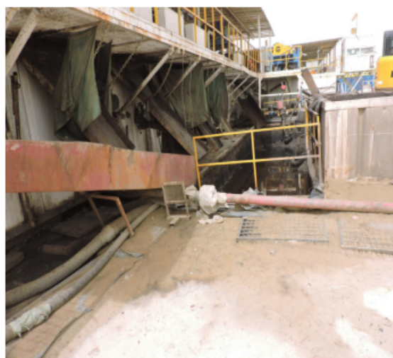
泥浆不落地设备
