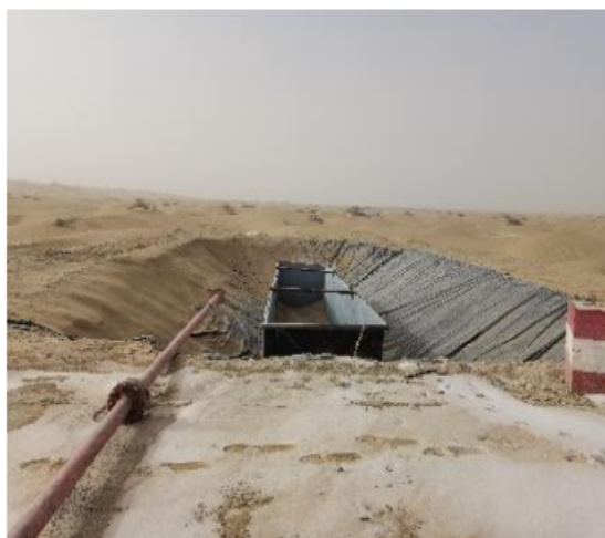
钻井期间井场设施
