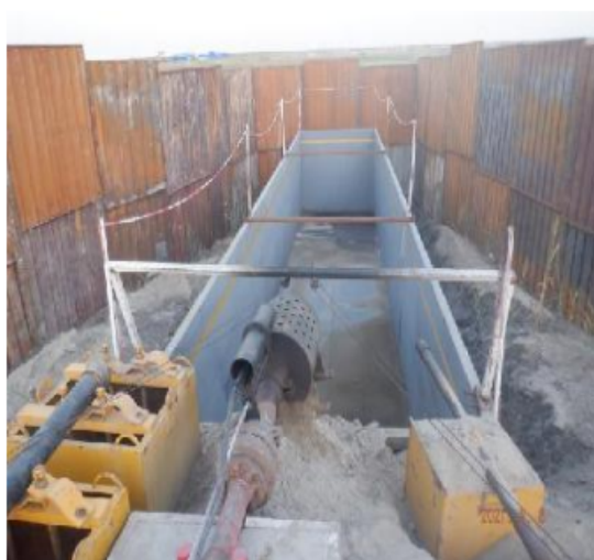
钻井期间井场设施
