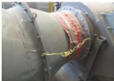
跨静电连接线
